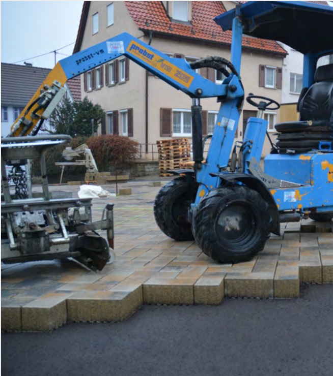
Die Verlegung des Pflasters erfolgte zu großen Teilen maschinell. (Bild: SF-Kooperation GmbH Beton-Konzepte)
