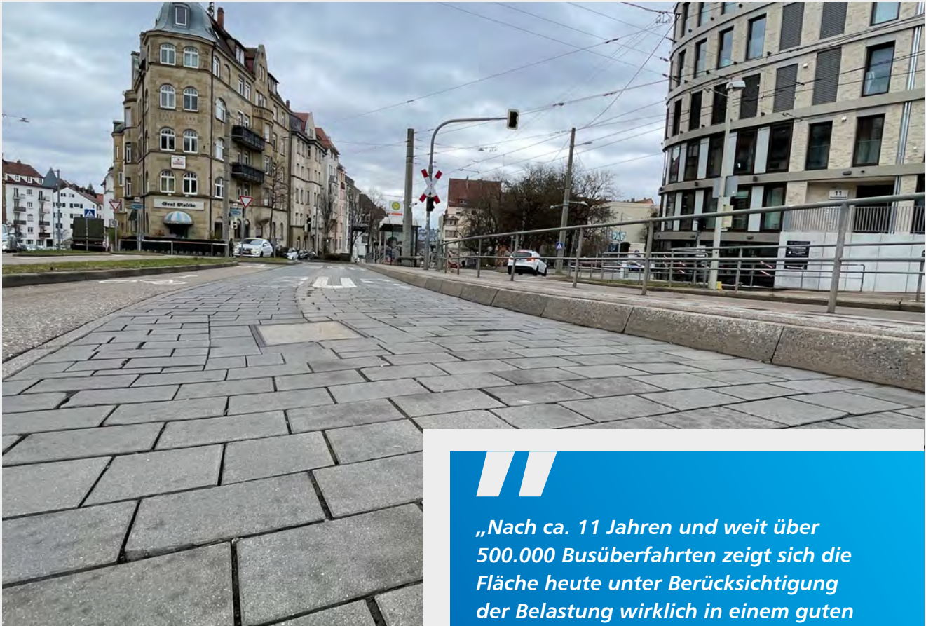
Die Bushaltestelle Vogelsang in Stuttgart im Februar 2024: Trotz Belastung der Fläche durch Busse, liegen die Pflastersteine noch wie am ersten Tag. (Bild: SF-Kooperation GmbH Beton-Konzepte)
